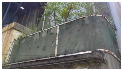
国道駅の機銃掃射痕（国道 15 号線側）
