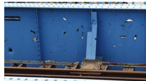
大川第 5 号橋梁の機銃掃射痕（大川橋より）
